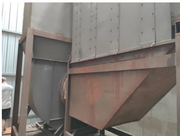
喷漆房废气处置装置
